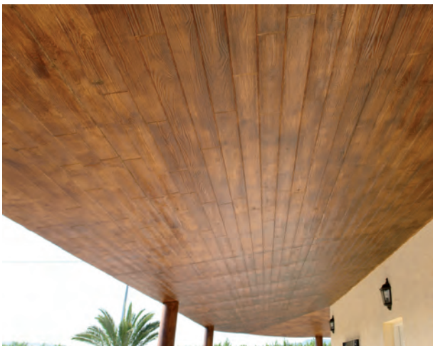
Acabado final en barniz. / EN.Final finish with varnish. / FR.Finition vernis. / DE.Betonbau mit Lackanstrich.
